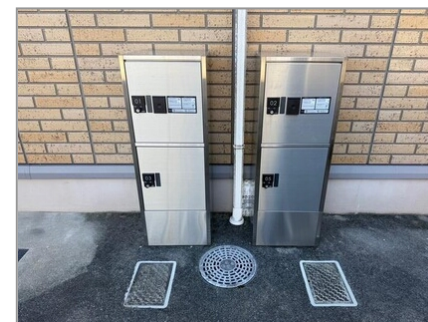
宅配ボックス
