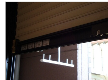
窓シャッター
