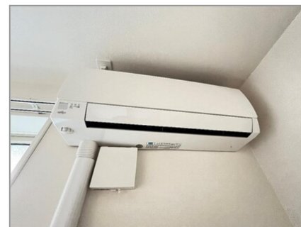
洋室エアコン
