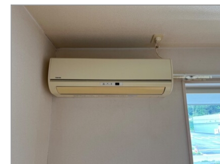
リビングエアコン
