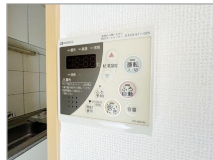
給湯器パネル
