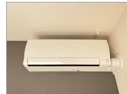
リビングエアコン
