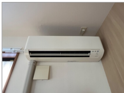
洋室エアコン
