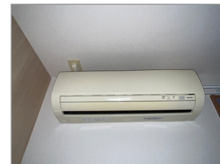
リビングエアコン
