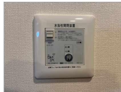
電動水抜栓(イメージ)
