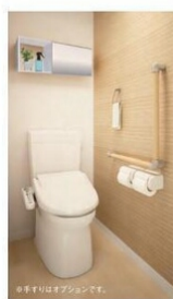
トイレ収納 人感センサー（照明）
