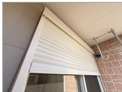
窓シャッター
