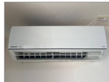
リビングエアコン
