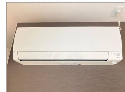
リビングエアコン
