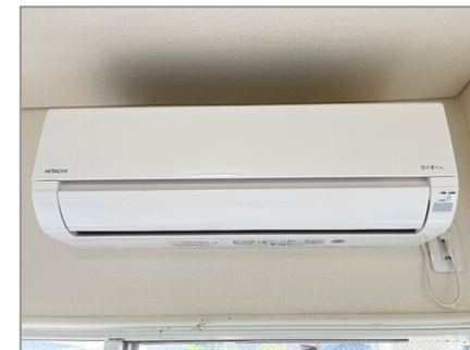
南西洋室エアコン
