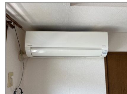
リビングエアコン
