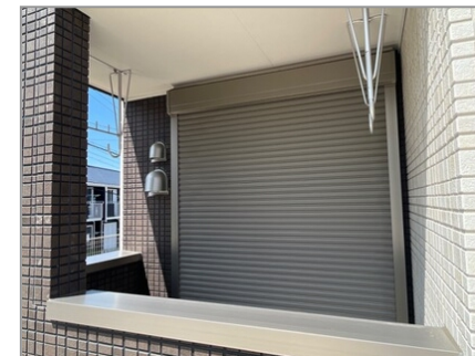
窓シャッター
