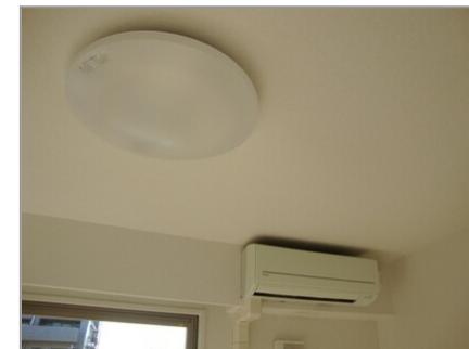
照明器具、エアコン
