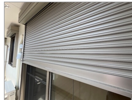
窓シャッター
