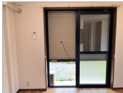
窓シャッター
