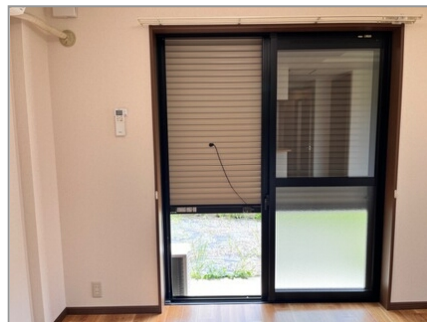
窓シャッター
