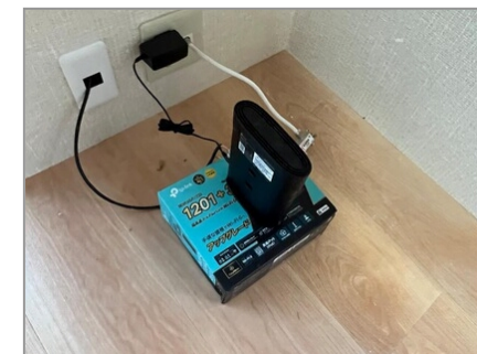
インターネット設備
