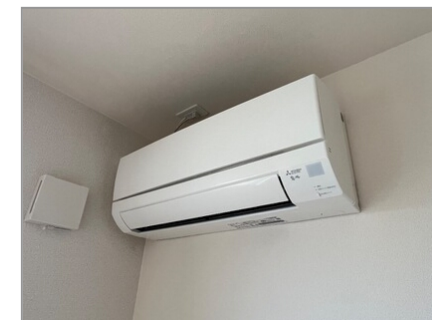
エアコン (北洋室)
