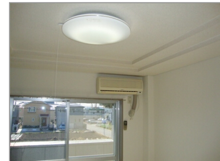
照明器具・エアコン
