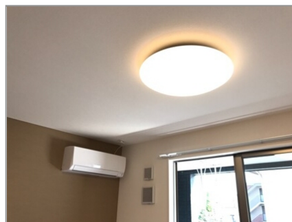
エアコン・照明
