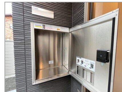
宅配ボックス
