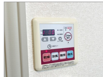
浴室暖房乾燥機
