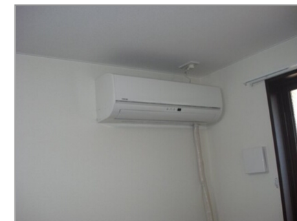
洋室エアコン
