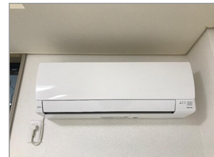
リビングエアコン
