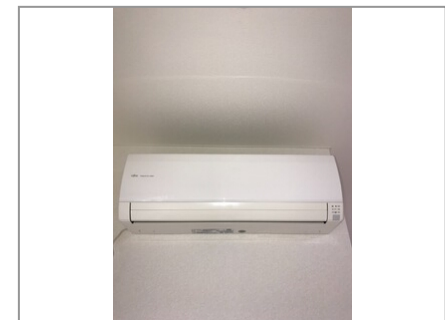
リビングエアコン
