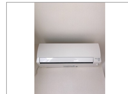
リビングエアコン
