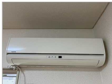
洋室エアコン
