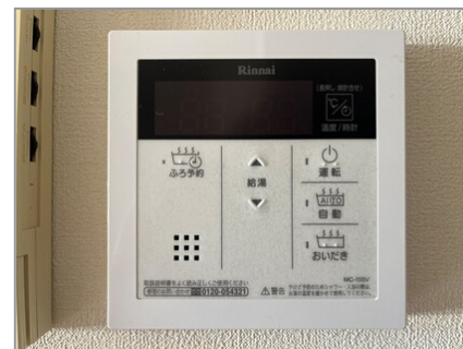
給湯器パネル
