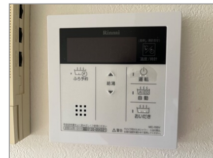
給湯器パネル
