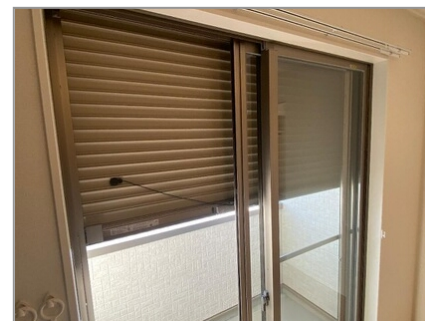
窓シャッター
