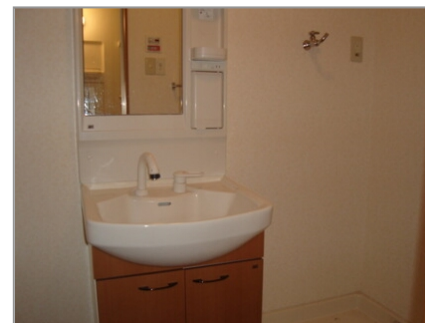
洗面(洗面化粧台)
