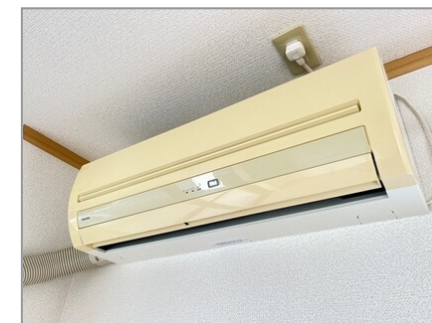
エアコン (リビング)
